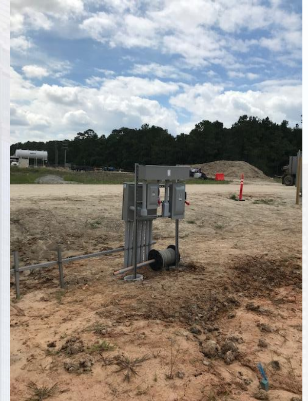
N. Plant Temp Power
